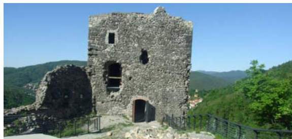
L'attuale ingresso alla torre semicircolare conduceva ad un ambiente voltato a botte. Per accedere ai piani superiori si passava all'esterno attraverso l'apertura a sinistra di cui sono ancora ben visibili i grossi blocchi squadrate con funzione di stipite.
